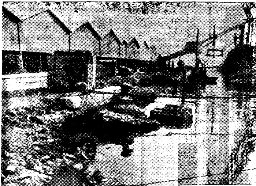
SFAX. — DEBUT DES TRAVAUX DE LA SECONDE MOITIE DU QUAI DES PHOSPHATES. ETAT DU MUR DU QUAI DEMOLI AVANT LES TRAVAUX
